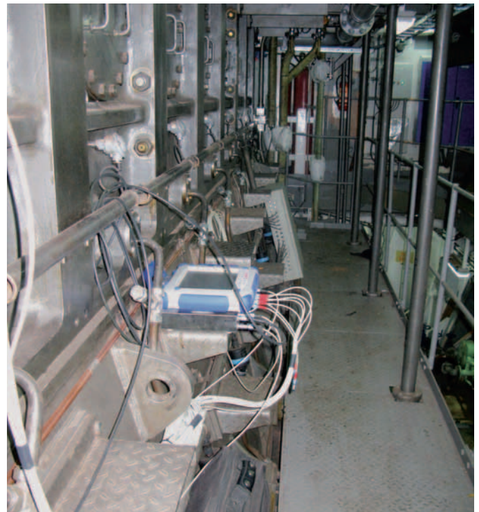
Abb. 1: „The Doctor“, installiert auf dem mittleren Deck der vermessenen Motorenanlage
